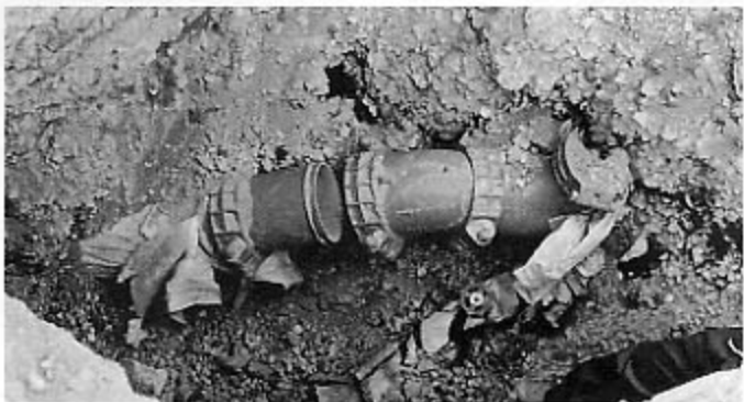
継手部が抜け出した給水管
