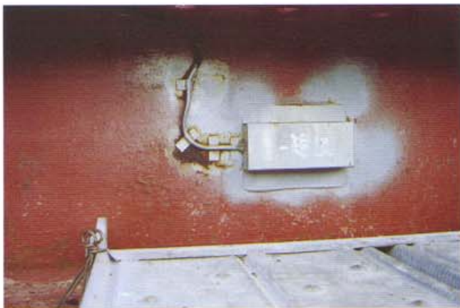
切梁に設置したひずみ計
